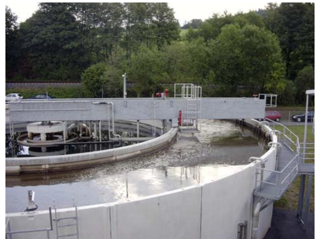
Rundkombibecken (Belebungs- und Nachklärbecken)
